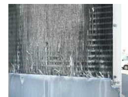
室外機の腐食
