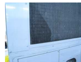
室外機の油にじみ
